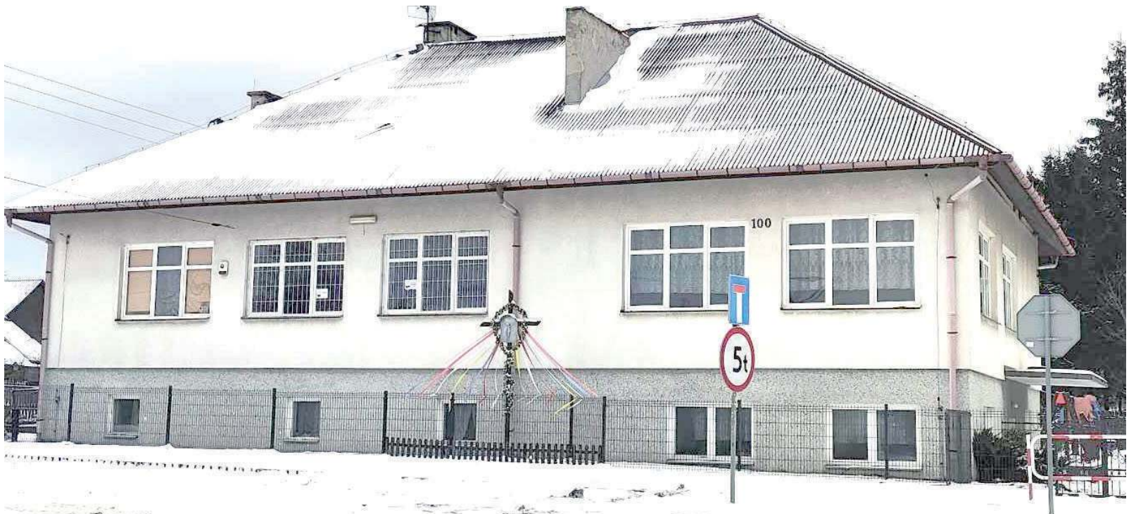
Szkola filialna w Lipowcu została zamknięta wraz z końcem roku szkolnego 2021/2022. Od tamtej pory budynek jest wykorzystywany sporadycznie, ostatnio jako lokal wyborczy. Sołtys Lipowca, Janusz Gnida, domaga się remontu dachu i zagospodarowania budynku
