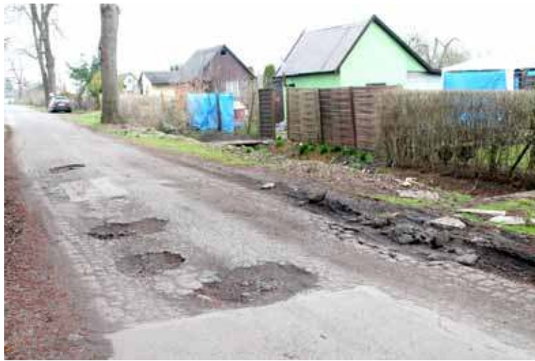
Jak widać dziury w jezdni są bardzo głębokie
