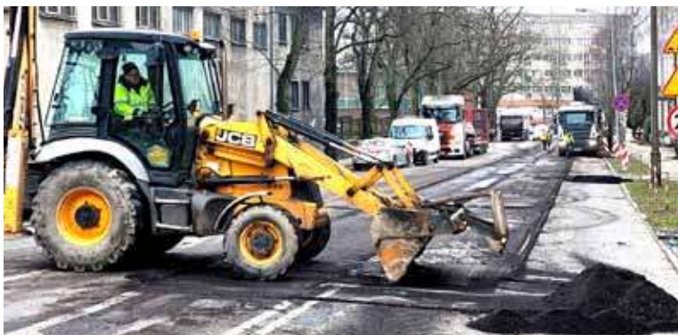
Nocne mrozy i plus na termometrze w ciągu dnia doprowadzają do ubytków w jezdni
