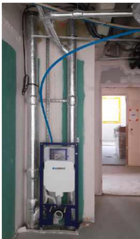
☞ Rury z plastiku tłumią odgłosy przepływających ścieków znacznie gorzej niż żeliwne, dlatego podczas remontu warto je wygłuszyć. ARMACELL
