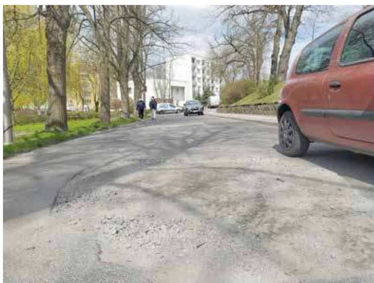
Zdewastowana nawierzchnia drogi przy ul. Zielonej będąca konsekwencją podmycia części gruntu pod powierzchnią
