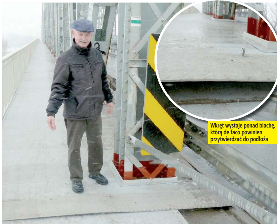
To w tym miejscu mieszkaniec Puław uszkodził but. Rzeczywiście blacha uniosła się do góry i wystają wkręty
