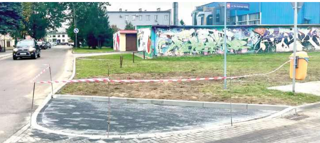
W listopadzie 2024 roku, już po zmianie władz miasta, odbiór inwestycji przesunięto z powodu usterek nawierzchni bitumicznej. Problem z szerokością wjazdu i uszkodzaniem krawężników stał się przedmiotem publicznej dyskusji dopiero po pojawieniu się zdjęć zniszczeń
