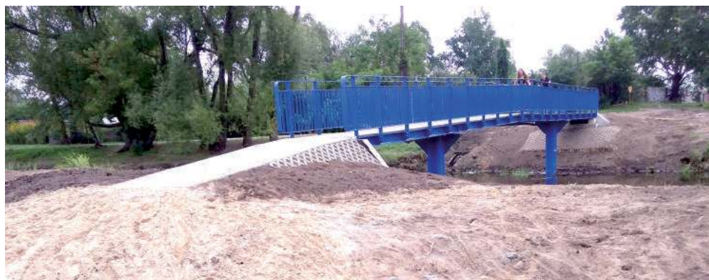
Kładka na przedłużeniu ul. Mickiewicza wygląda zgrabnie i efektownie, ale jadąca nią na wrotkach dziewczyna musiała przy zejściu skorzystać z pomocy chłopca
