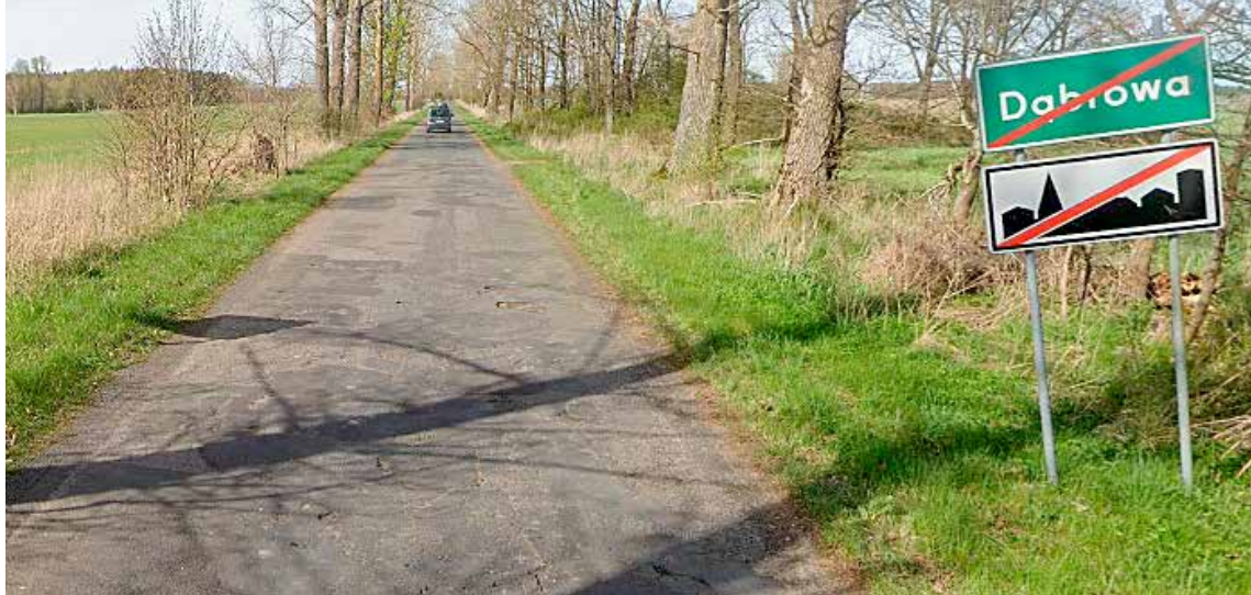
Część dróg powiatowych w gminie Nowogard nie miała okazji przejść kompletnego remontu od 50 lat. Przykładem odcinek Dąbrowa - Bochlin
