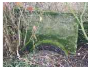
– Rowy melioracyjne pozostały chaszczami, urządzenia melioracyjne wyburzono lub zdewastowano. Nie ma żadnej retencji. Woda ucieka do Bałtyku, zamiast nawadniać pola i podnosić poziom wód gruntowych – tłumaczy 68-latek.
