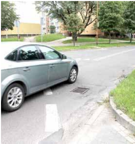
Przed remontem, kierowcy zmuszeni byli tak wymanewrować auto, by nie wpaść w zagłębienie asfaltu, dodatkowym utrudnieniem była studzienka
