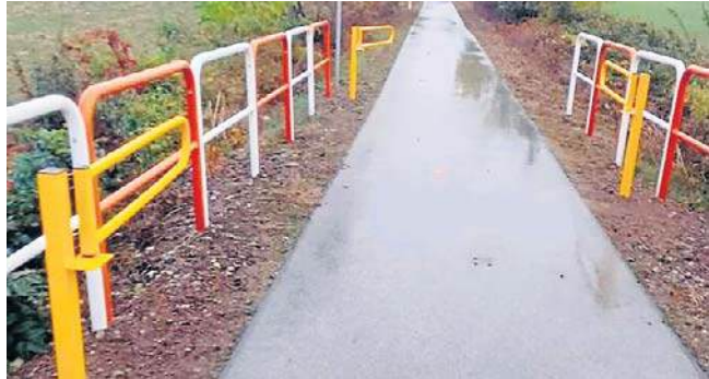
Uszkodzone blokady na ścieżce pieszo-rowerowej Gołanecz-Lipiny
