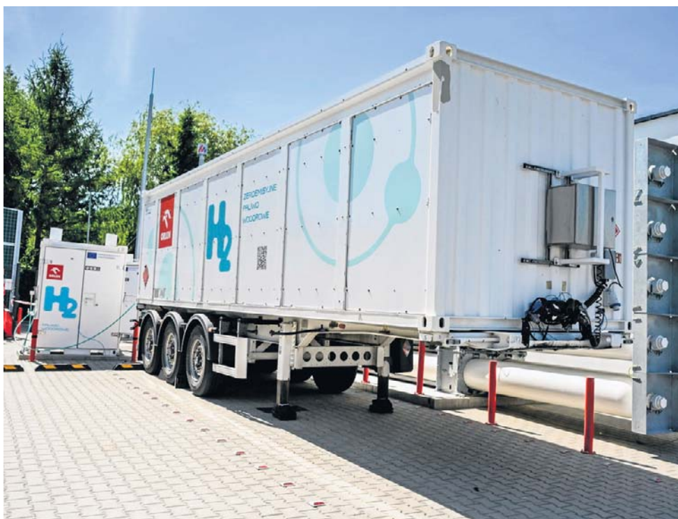
Wodór na stacji jest magazynowany w mobilnych naczepach
