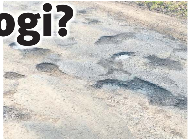
Odcinek drogi Krajenki – Drożdżenica jest w takim stanie. Nie ma kawałka asfaltu bez dziury.
