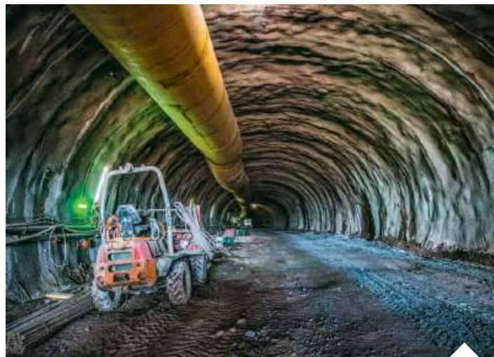
Ta żółta rura na górze służy do napowietrzania tunelu | fot. Tomasz Hamrat/Gazeta Polska
