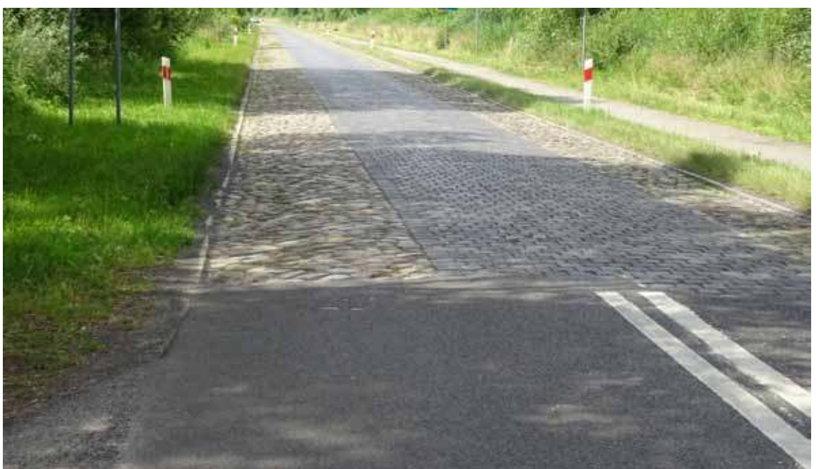
Fragment jezdni za mostem ma być poprawiony
