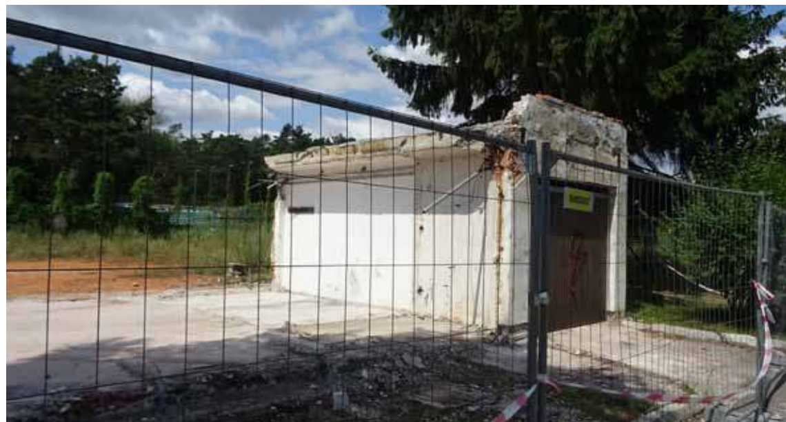
Tyle we wtorek zostało z budynku szatni na kortach
