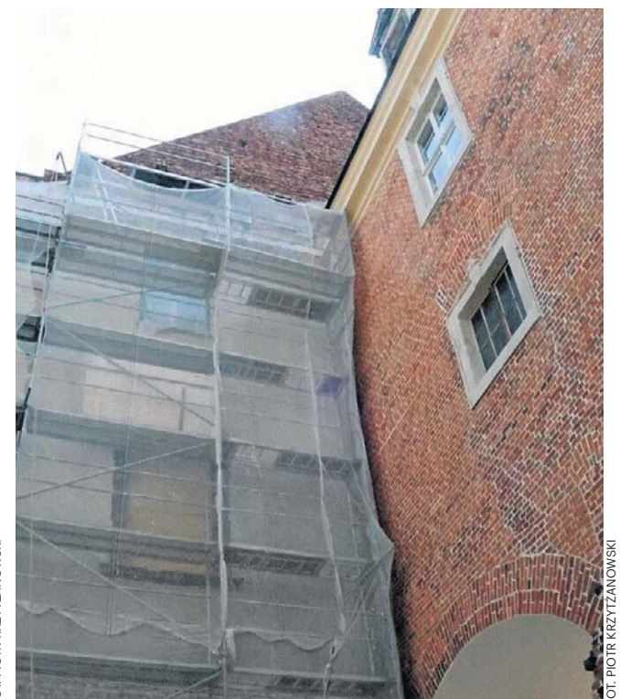
Po remoncie bramy okazało się, że z kolejnej ściany zaczęło się sypać
