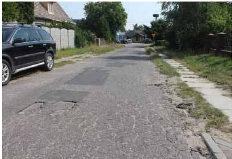
Na ul. Kossaka wciąż w złym stanie znajdują się tak droga jak i chodnik
