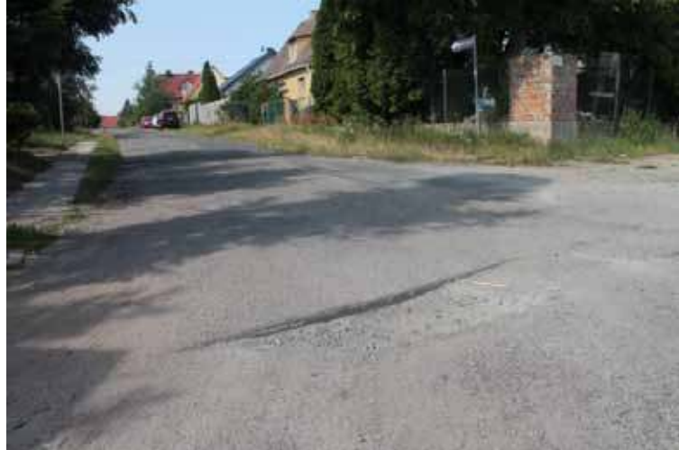
Zjeżdżając z Podmiejskiej na Kossaka trzeba uważać na tę dziurę z ostrą krawędzią uciętego asfaltu
