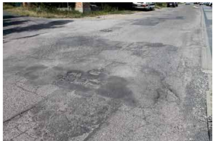
Stan nawierzchni ulicy Podmiejskiej w okolicach skrzyżowania z Kossaka pozostawia, jak widać, sporo do życzenia
