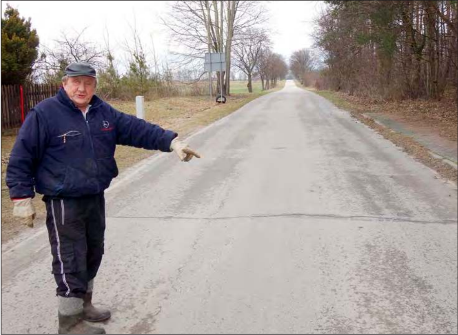
Henryk Pawlak mieszka przy głównej drodze w Korzeniowie od blisko 30 lat. - Remont jest potrzebny, bo droga jest zniszczona. Są na niej doły i pęknięcia - mówi mężczyzna
