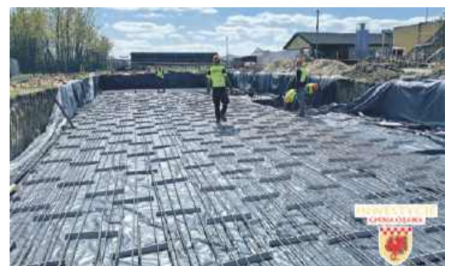
Oczyszczalnia ścieków w Stanowicach
