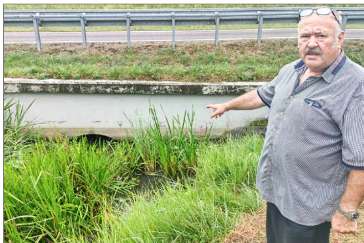
Wiesław Kita pokazuje ledwie drożny przepust.
