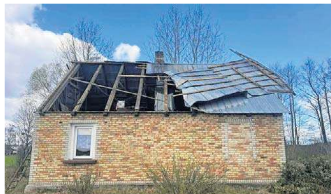
W poniedziałek w Pogorzalkach niedaleko Białegostoku wichura zerwała część dachu z domu jednorodzinnego. Na szczęście nikt nie ucierpiał
