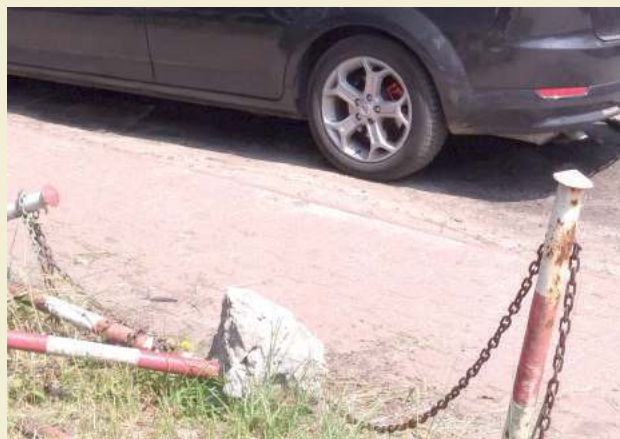
Niedaleko od budynku starostwa od dawna szpecą wyrwane słupki. Prawdopodobnie jest to nieruchomość powiatowa, która nie znalazła się w planach działań promocyjnych pow. bialskiego
