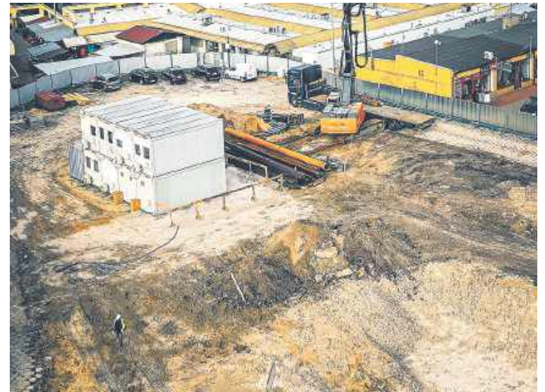
Plac po byłym dworcu PKS w Chełmie. Po ambitnym planie budowy „biurowca klasy A” został wielki wykop (fot. UM Chełm, arch.)
