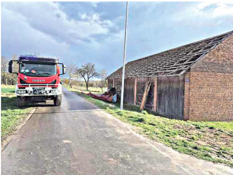
W Wólce Abramowskiej silny wiatr zerwał dach ze stodoły
