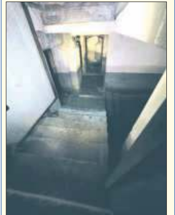
Woda z uszkodzonych instalacji zalała piwnice i posesje.
