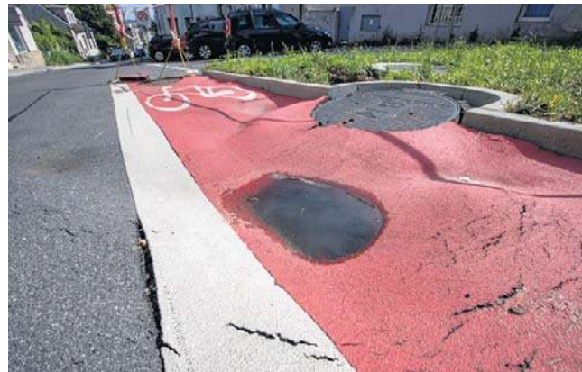
- Trwa ustalanie przyczyn powstałych uszkodzeń nawierzchni asfaltowej - informują służby prasowe MWiK
