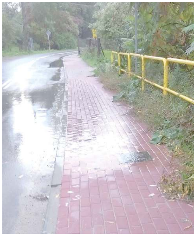
Szambo wybija z trzech studzienek kanalizacyjnych znajdujących się na odcinku od starego banku w kierunku ul. Plebani
