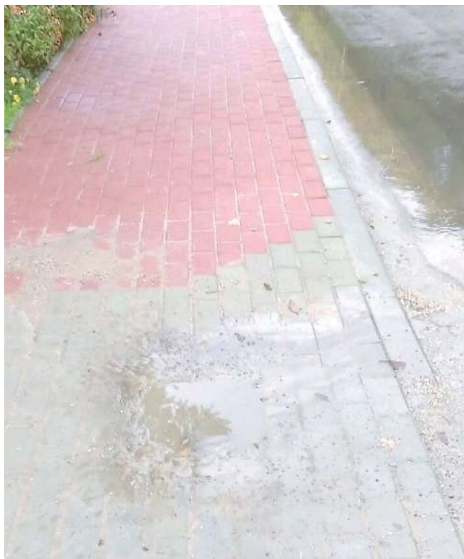
To zdjęcie otrzymaliśmy 27 września. Przedstawia jedną ze studzienek kanalizacyjnych na ul. Starowiejskiej w Karczmiskach Pierwszych, z której tego dnia wypływało szambo
