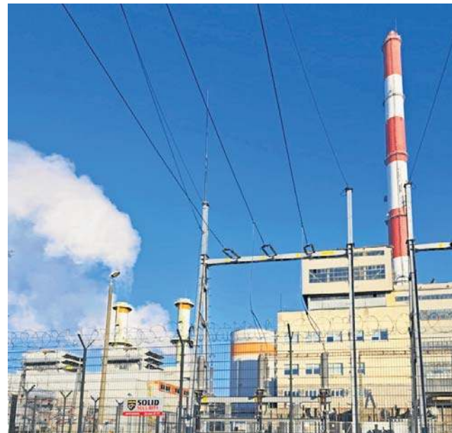
Nowoczesna elektrociepłownia (na zdjęciu stary i nowy zakład) zaopatruje w ciepło 60 procent miasta
