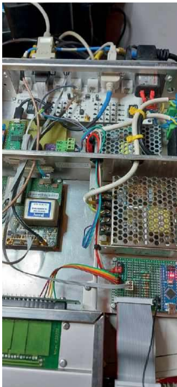
3Z6AEFT&F - wnętrze urządzenia
