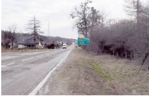
Stan drogi stwarza zagrożenie dla kierowców.
