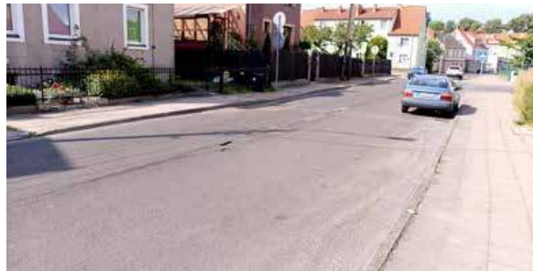
Nawierzchnię ulicy Konopnickiej znaczą liczne dziury
