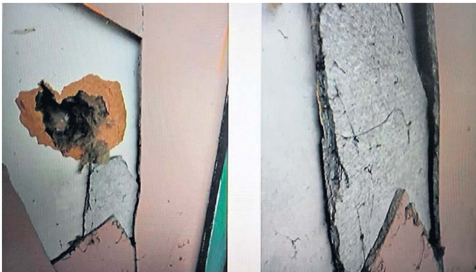
Zdjęcia azbestu odkrytego wewnątrz ścian w budynku Miejskiego Przedszkola nr 9
