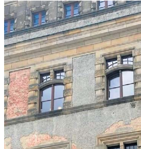
Elewacja budynku potrzebuje solidnej modernizacji
