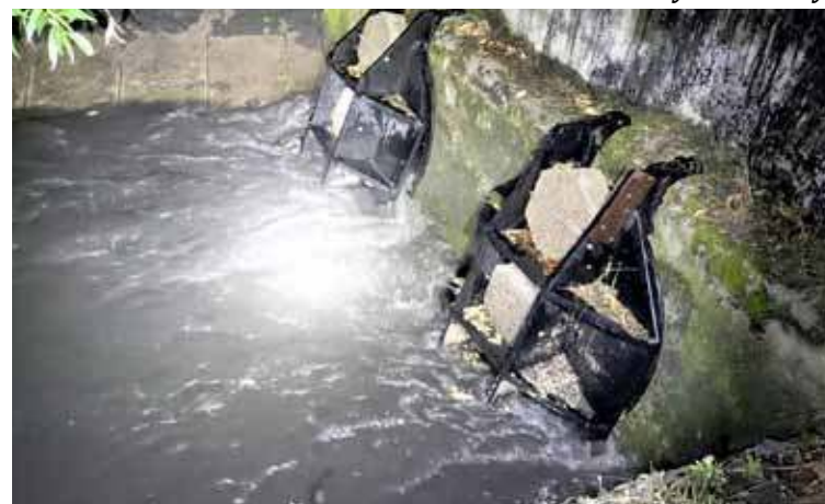
Kolektory spustowe - to przez nie miały popłynąć ścieki
