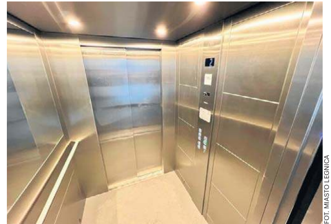
Inwestycja kosztowała ponad 412 tys. zł. Winda zjeżdża do poziomu „0”. Można do niej wjechać wózkiem z podwórza
