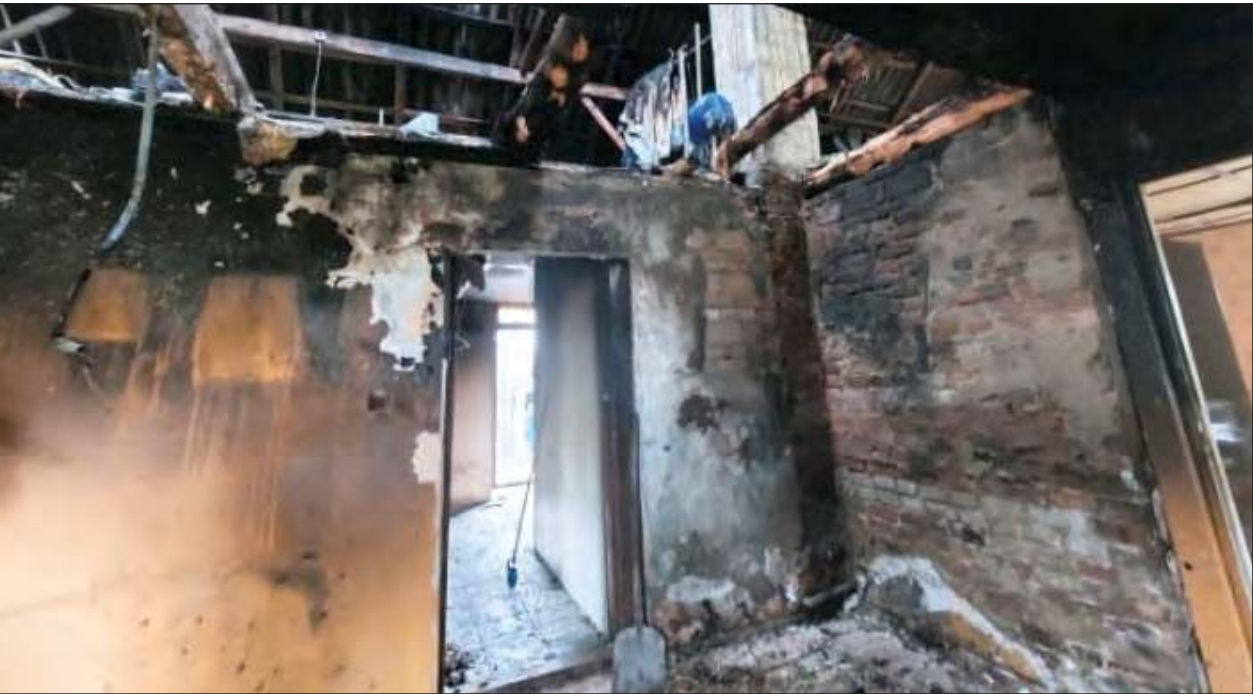
Budynek nie nadaje się do zamieszkania
