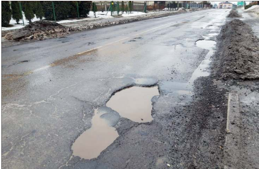
Kokoszycki odcinek Młodziejowej to regularna rompla. Po zimie największe dziury zostały załatane, ale to nie rozwiązuje problemu niedokończonego remontu, tym bardziej, że WINB po swojej kontroli uznał, że trwa tam budowa.
