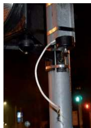
Uszkodzony przez wandalę sygnalizator
