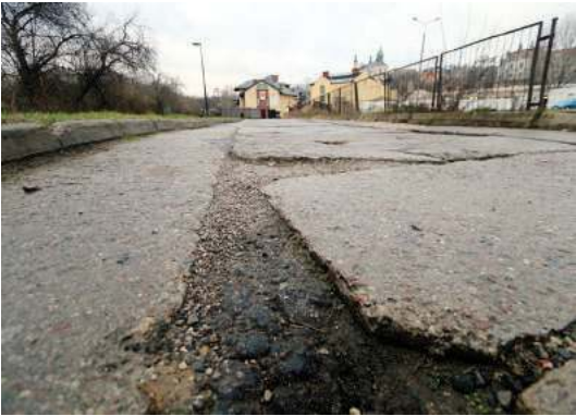
Do Caritas prowadzi droga z połamanymi, betonowymi płytami
