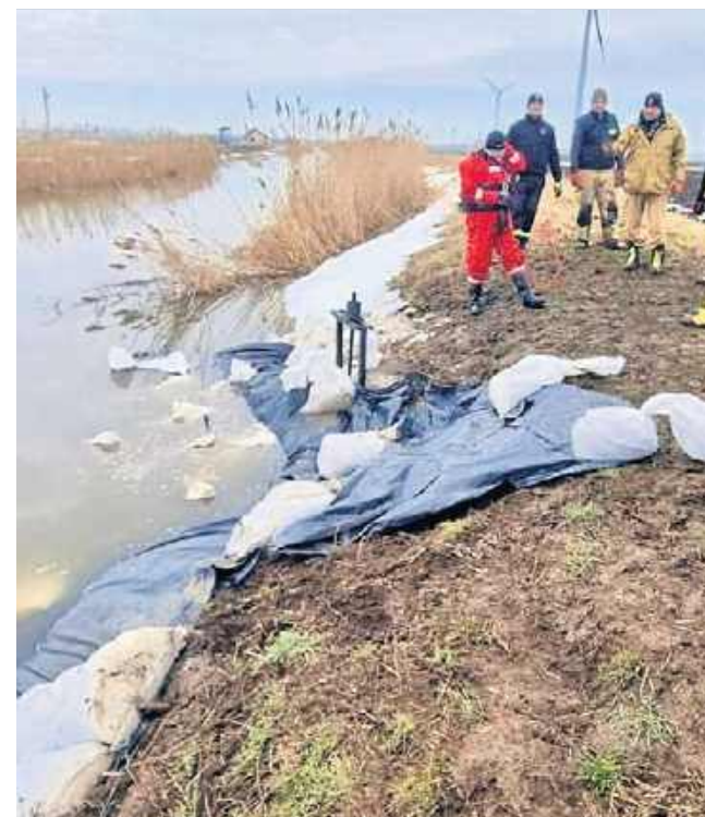
Pod koniec zimy wał uszkodzony przez bobry był przyczyną podtopienia pola w gminie Nowy Staw
