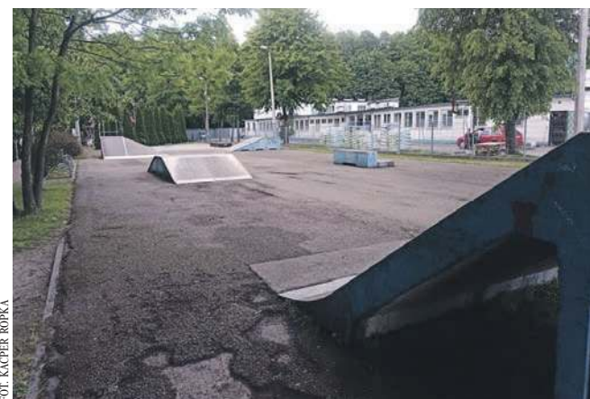
Zniszczony skatepark w Krzeszowicach
