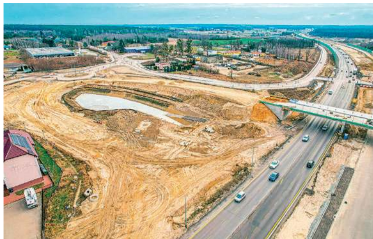
Na odcinku Płońsk – Żaluski zaawansowanie prac wynosi obecnie 66 proc., więc zakończenie rozbudowy do maja b.r. nie wydaje się możliwe. W przypadku pozostałych dwóch odcinków S7 termin wykonania robót został przedłużony do sierpnia
