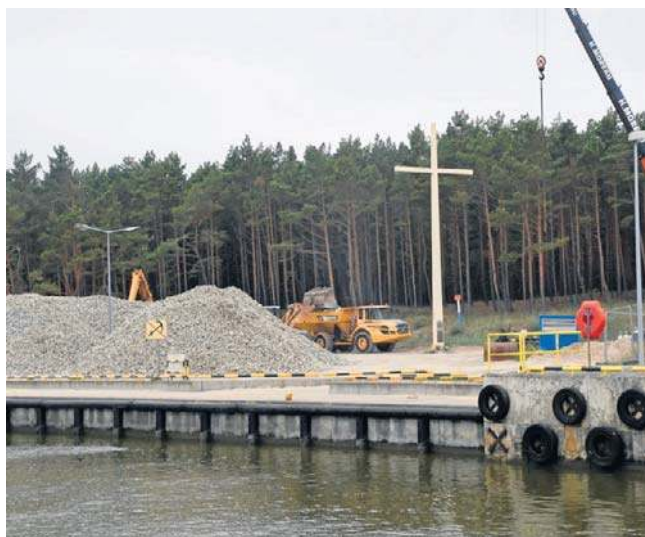
Trwają prace przy przebudowie portu w Łebie na potrzeby morskich farm wiatrowych
