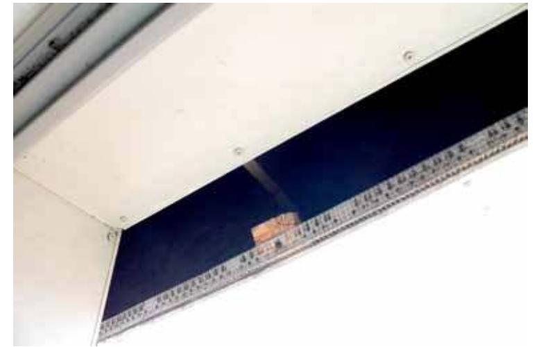
Powstała szczelina między ścianą a zerwanym gzymsem jest spora
