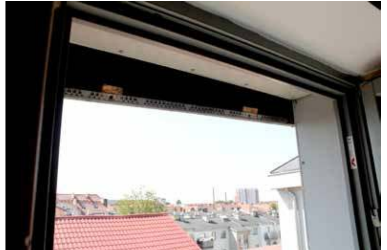
Nad oknem łazienki taki widok zerwanego gzymsu jest już od końca lutego
