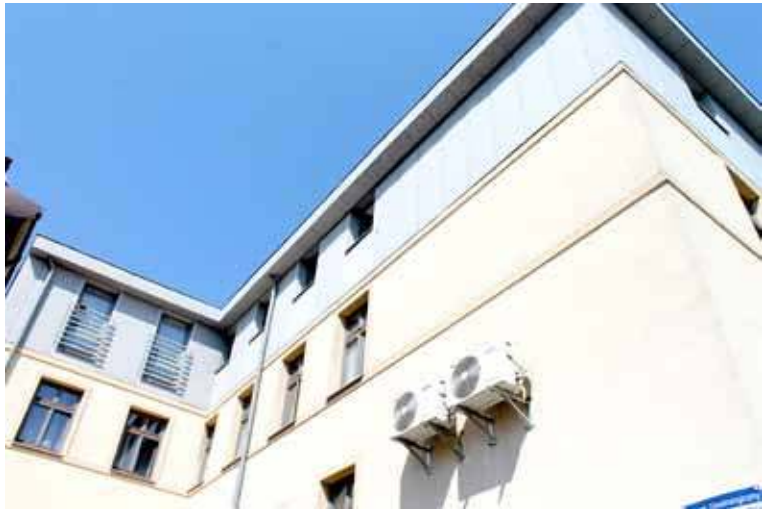
Gzyms grozi runięciem z trzeciego piętra na podwórze
