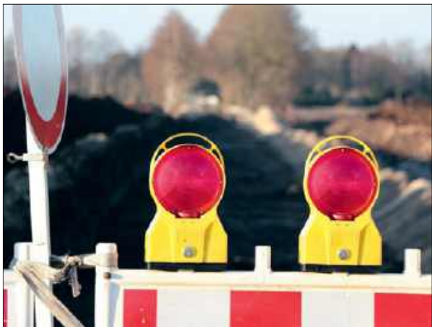
GDDKiA poinformowała kąkolewnickich urzędników, że za szkody na drogach poczynione przez firmy pracujące przy budowie S19, nie będzie odpowiadał Skarb Państwa czy GDDKiA
