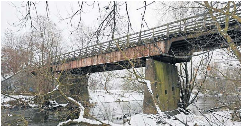
Stary most na Drwęcy między Kaszczorkiem i Złotorią będzie jednak remontowany
