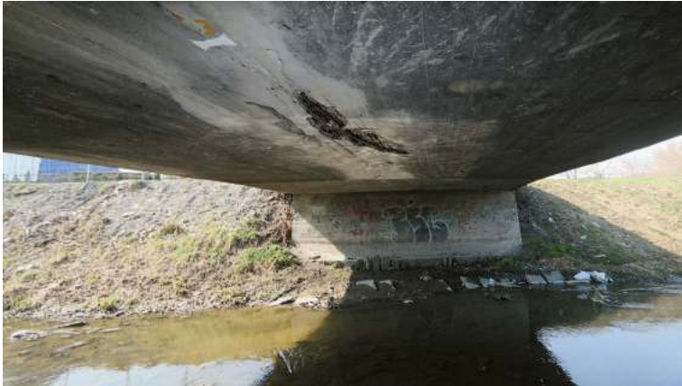
Most nad Czerniejówką na ulicy Pawiej jest w kiepskim stanie i musi zostać zastąpiony nową konstrukcją
