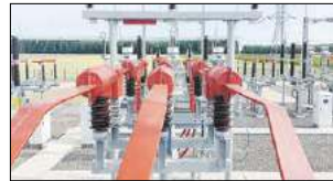
Jeden z Głównych Punktów Zasilających powstał w ubiegłym roku w gminie Huszelew
