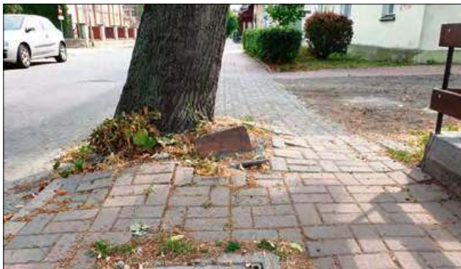
Przejście w tym miejscu może być niebezpieczne.
