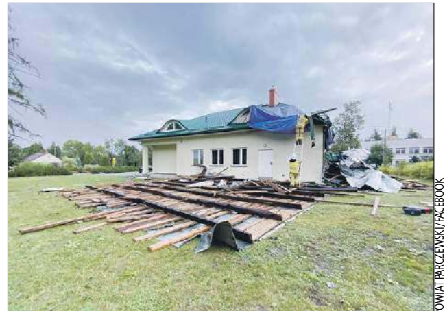
W powiecie parczewskim 23 zdarzenia dotyczyły uszkodzonych lub zerwanych całkowicie dachów
