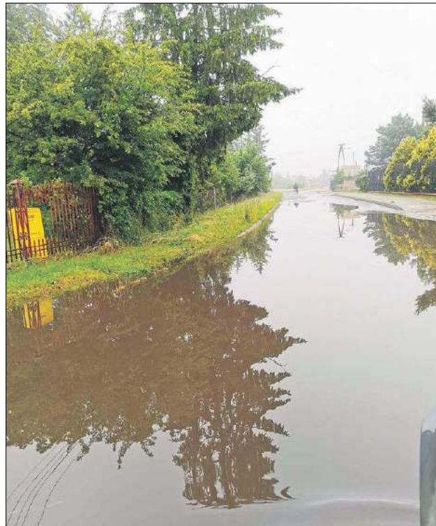
W czerwcu u władz miasta interweniował mieszkaniec osiedla Grzybowa w sprawie zalanej ulicy (na zdjęciu). Otrzymał odpowiedź, że kwestię rozwiązać ma studnia drenażowa
